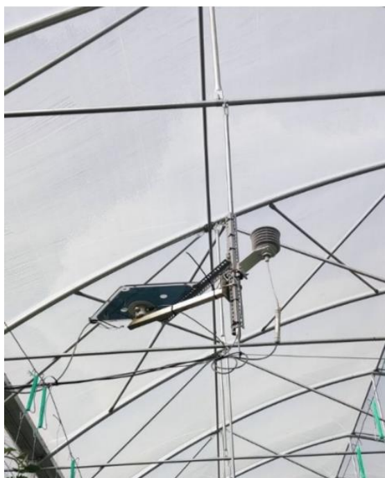
Εικόνα 1. Το σύστημα αισθητήρων όπως έχει εγκατασταθεί στο θερμοκήπιο
